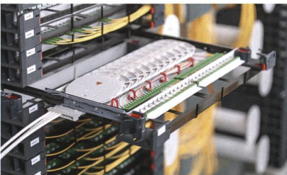
Neue Einschübe für das Fasermanagement.
