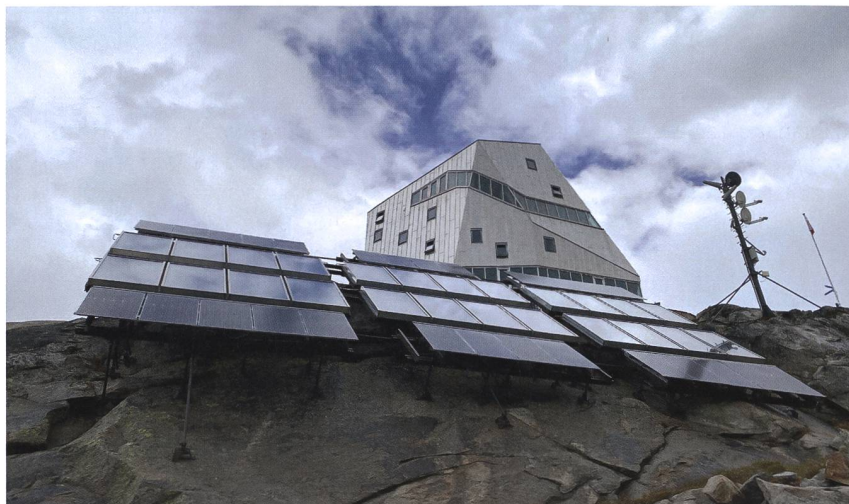
Bild 4 Sonnenkollektoren (zwei mittlere Reihen) liefern Wärme für Heizung und Warmwasser. 2013 wurden zudem zusätzliche PV-Module installiert, um den Strom-Deckungsgrad zu erhöhen.
