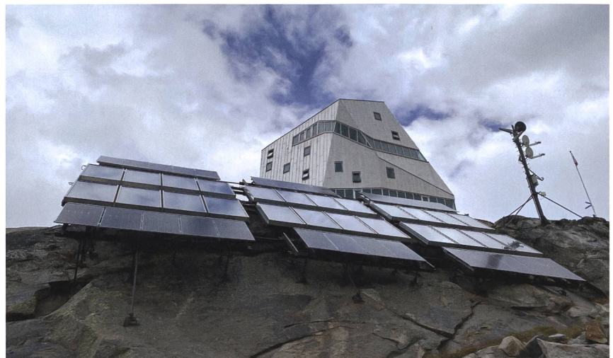
Bild 4 Sonnenkollektoren (zwei mittlere Reihen) liefern Wärme für Heizung und Warmwasser. 2013 wurden zudem zusätzliche PV-Module installiert, um den Strom-Deckungsgrad zu erhöhen.
