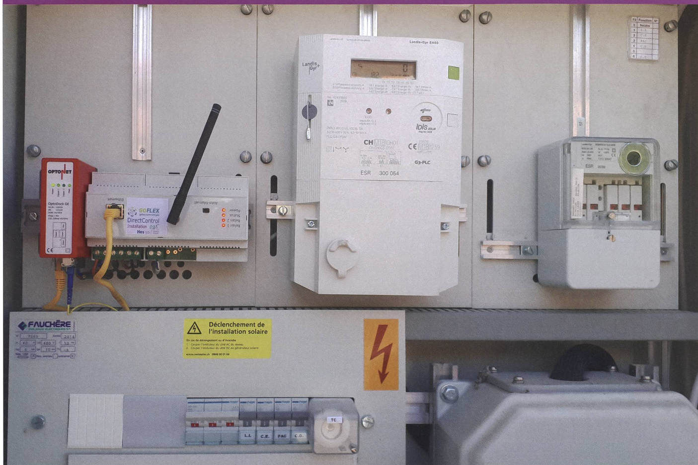
Coffret d'entrée d'une maison équipée de façon à pouvoir gérer son potentiel de flexibilité.
