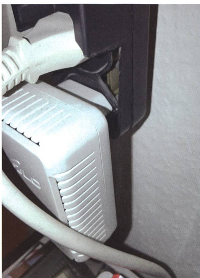
Defekte Steckdosenleiste in einem Kinderzimmer.
