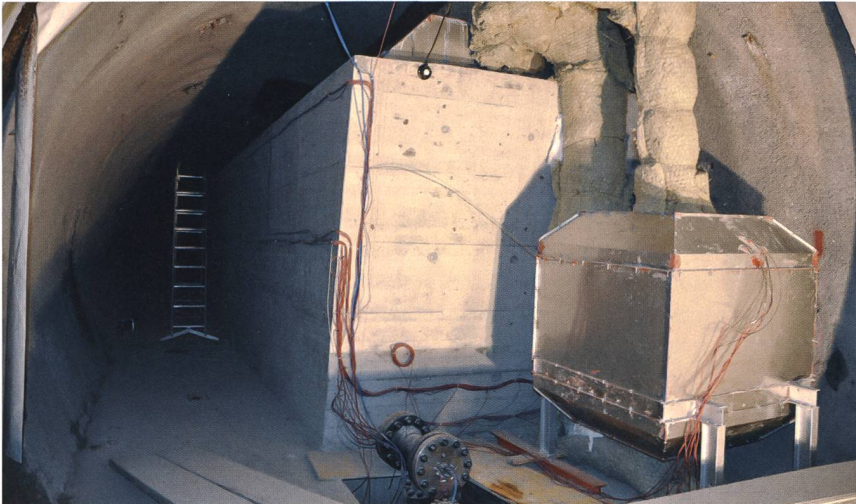
Sensibel-latenter thermischer Speicher in der Pilotanlage bei Pollegio. Links ist der mit Kieselsteinen gefüllte sensible Speicher, rechts der latente Speicher zu sehen. Der sensible Speicher ist 3,1 m hoch, 9,9 m lang und 4 m breit. Der latente Speicher ist etwa 1,5 m hoch, lang und breit.
