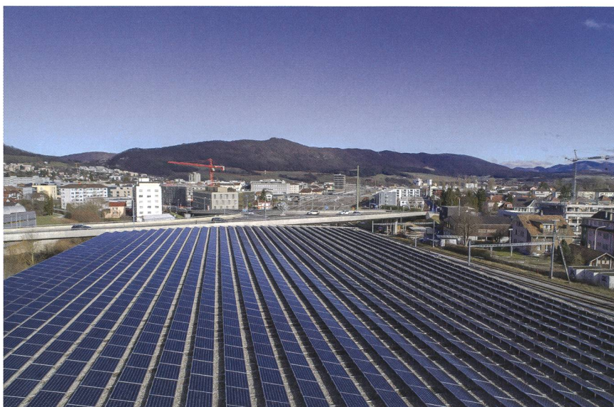
Sur le toit de la patinoire de Delémont, première centrale PV financée grâce au prêt citoyen.
