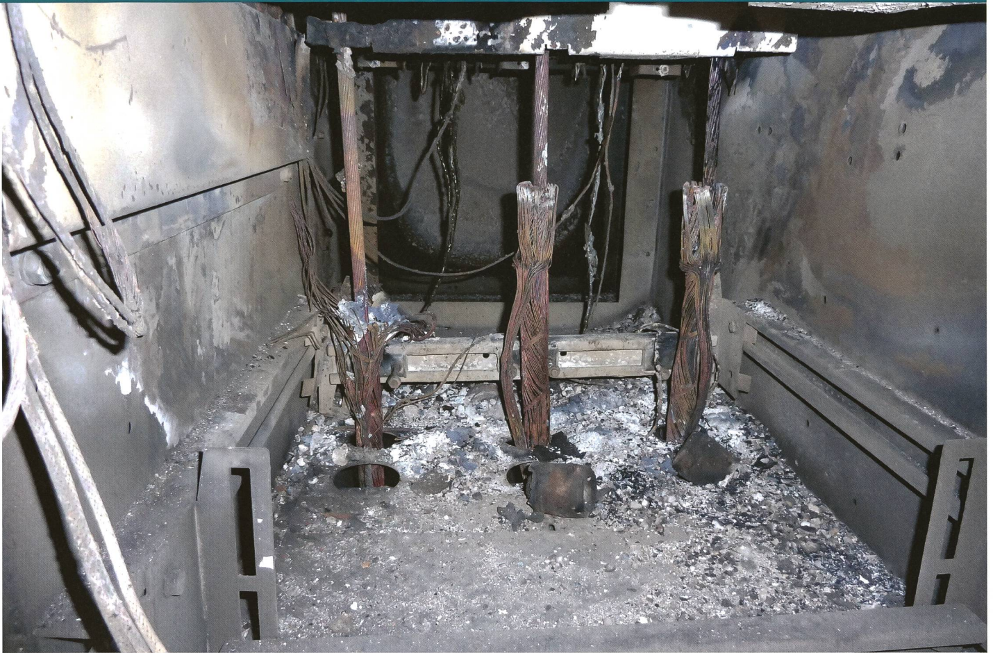
Zerstörte Zelle einer Mittelspannungs- Schaltanlage.
