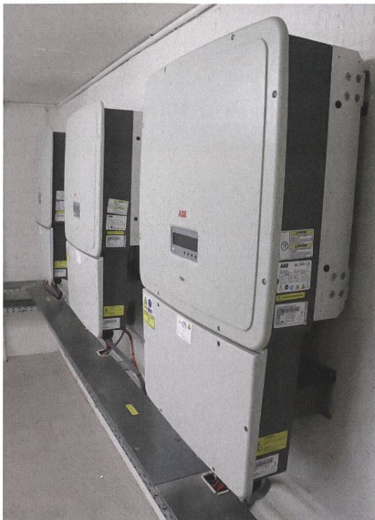
Bild 1 Die PV-Wechselrichter bei Camille Bloch können auch zur Kompensation von Blindleistung eingesetzt werden.
