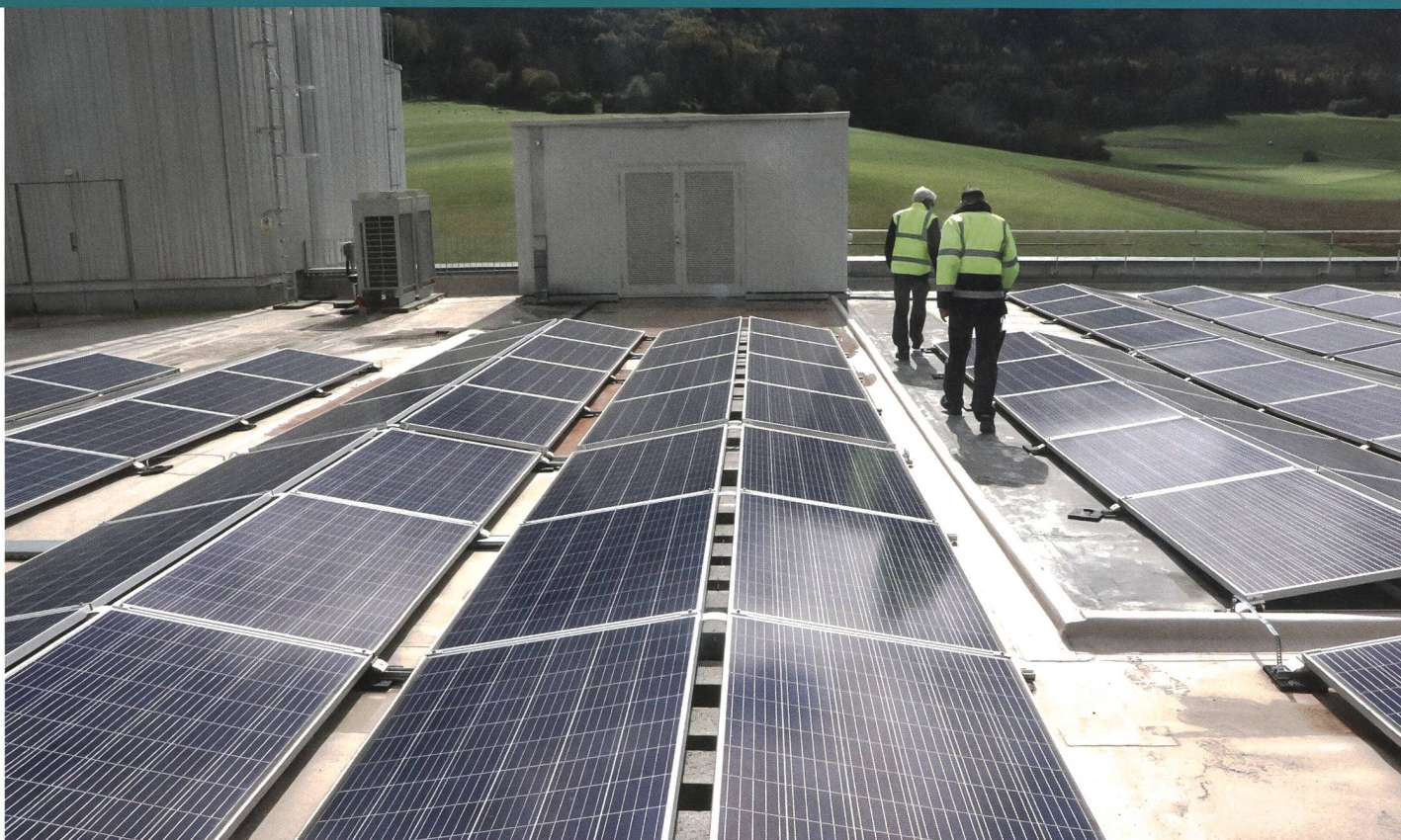
PV-Anlage bei Camille Bloch.
