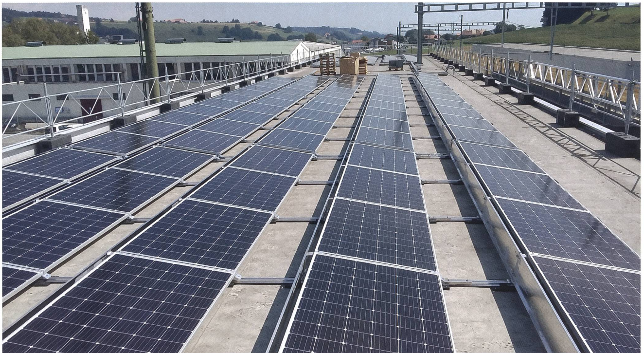
En collaboration avec un contractant, les Transports publics fribourgeois (TPF) ont réalisé des installations photovoltaïques sur les toitures des quais, sur quatre sites jusqu'à présent (sur la figure : la gare de Belfaux). La taille de l'installation PV est adaptée au potentiel de consommation propre de la gare en question. Environ 60 % du courant produit peuvent être consommés directement sur place (dispositifs de sécurité, publicité, distributeurs de billets, ventilation).
