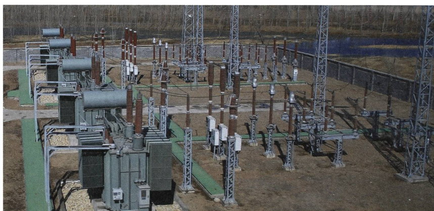
Bild 2 Freiluftanlage eines Bahnumspannwerkes an 3 AC 220 kV 50 Hz mit je zwei Einphasenumspannern 31,5 MVA in V-Schaltung, davon zwei in Stand-by-Modus, an 3 AC 220 kV 50 Hz.
