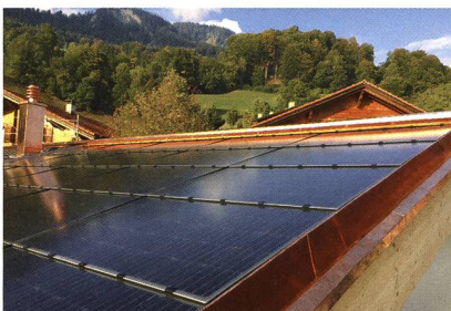
PV-Anlagen für den Eigenverbrauch.
