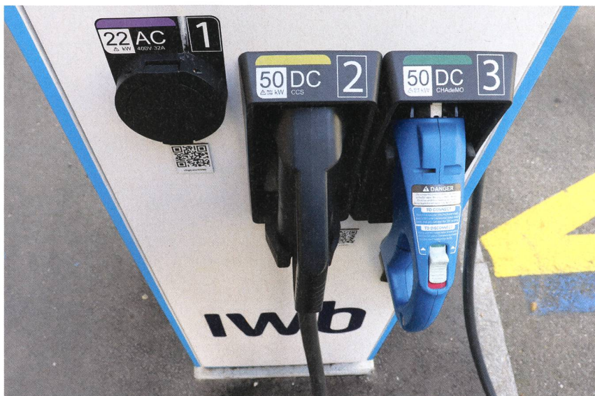
Figure 1 Cette borne dispose de trois points de recharge: à gauche, la prise d'une puissance de 22 kW et, à droite, deux connecteurs d'une puissance de 50 kW chacun.
