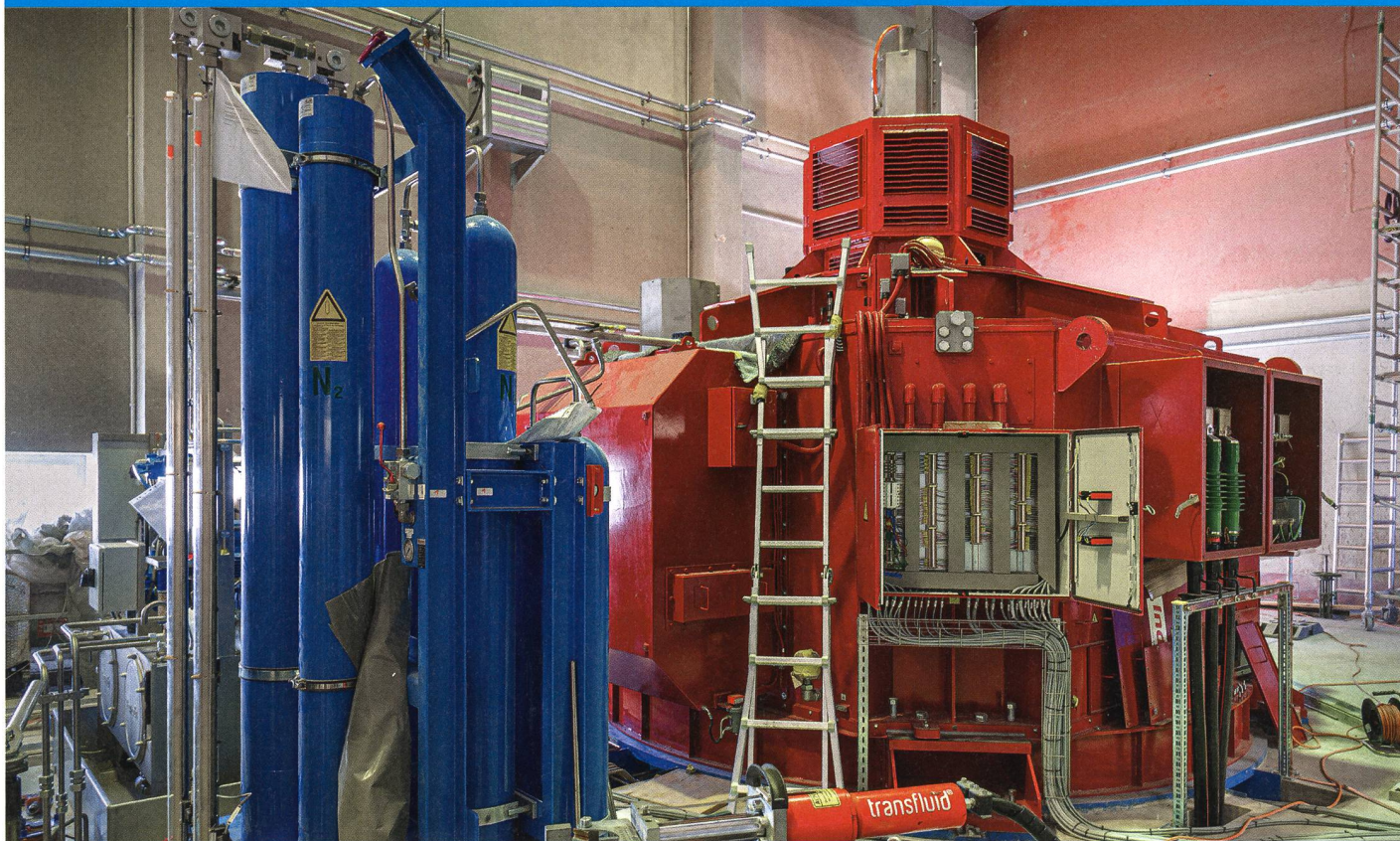
Einer der neuen Generatoren im Kraftwerk Dietikon.
