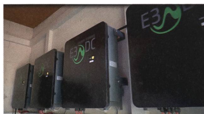
Solarwechselrichter im Gerkenhof, die in das Regelungskonzept eingebunden sind.
