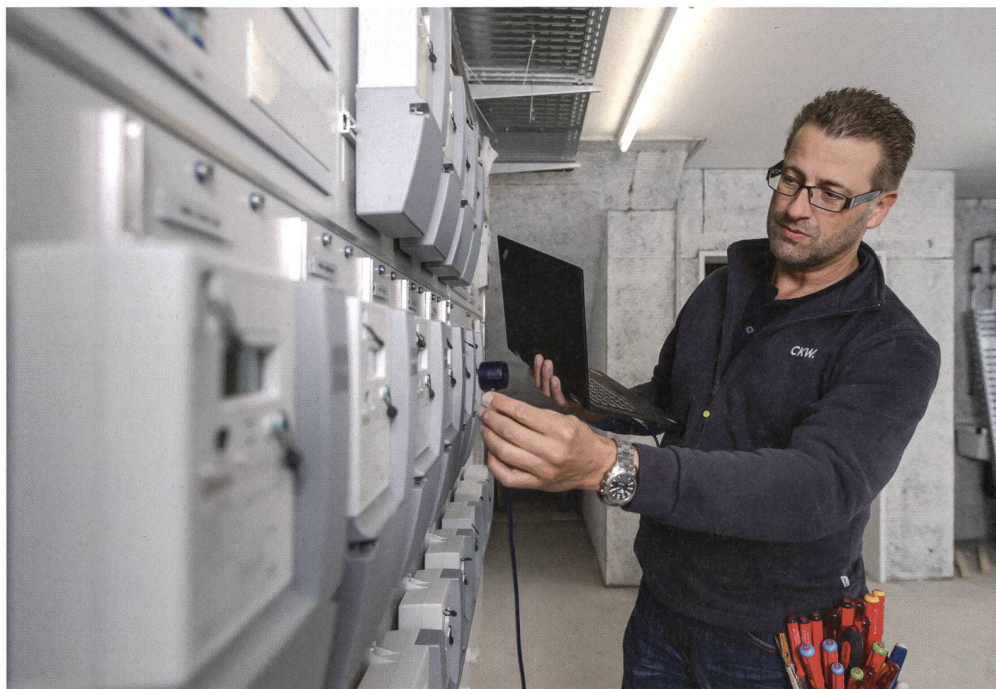
CKW setzt auf Stromzähler mit RF-Meshed-Technologie.
