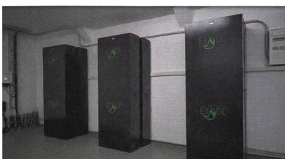
Die Quattroporte-Linea-Energiespeicher können jeweils 52 kWh speichern.
