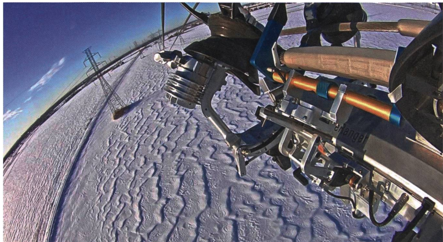
Figure 5 Réalisation de mesures sur un manchon de jonction, sous une tension de 735 kV.
