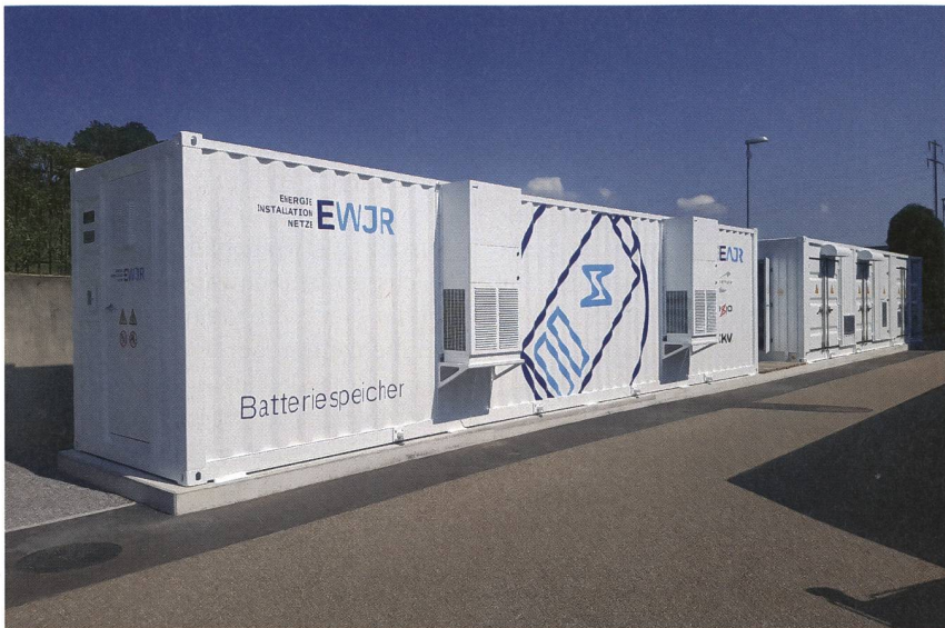
Nach der Installation wurde der Batteriespeicher für die Elektrizitätswerk Jona-Rapperswil AG in Betrieb genommen.
