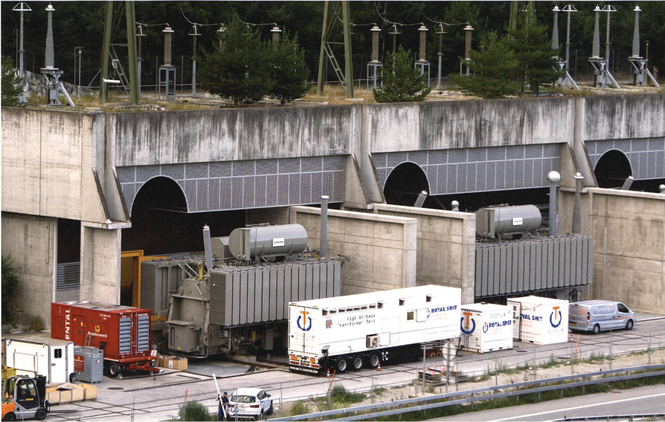
Phasenschieber-Transformator von Swissgrid in Chippis.
