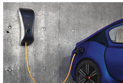
Ladestation mit Lademanagement.
