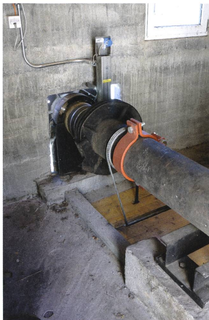
Ein Stahlseil betätigt die Antriebsachse der Stauklappe.
