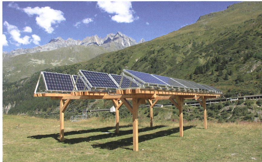
Figure 1 Structure pilote installée à proximité du lac des Toules afin de déterminer l'angle d'inclinaison optimal et la technologie de panneaux la mieux adaptée au site.
