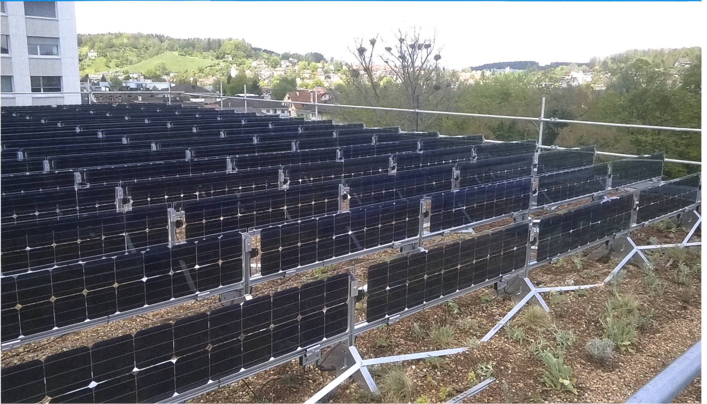
Vertikal montierte, bifaziale Lamine in Ost/West-Ausrichtung in schmaler, 20-zelliger Ausführung auf einem Gründach in Winterthur.
