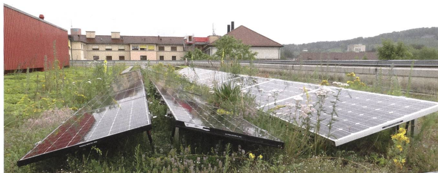
Bild 1 Der Bewuchs auf Gründächern kann zu einer nachteiligen Abschattung der PV-Anlage führen. Wartungsarbeiten werden wiederum durch eine dichte Belegung mit PV-Modulen erschwert.
