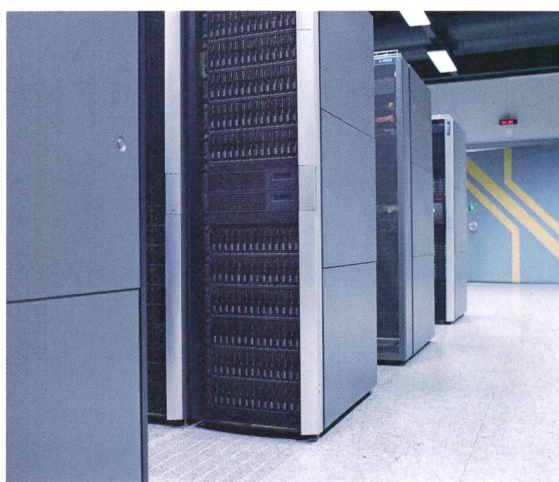
Ein Rechenzentrum als Beispiel für einen Stromgrossverbraucher.
