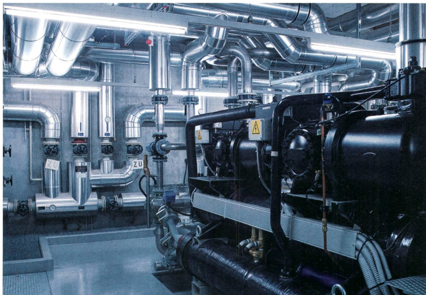
Ein Blick in die Kühleinheit des Rechenzentrums.
