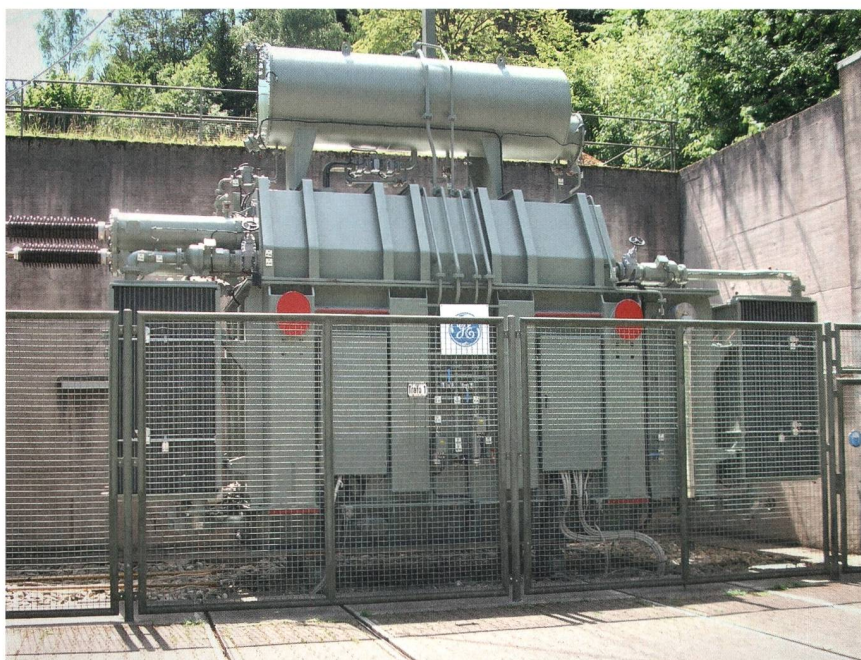
Bild 3 Neuer Blockumspanner 2 AC 10,75/110 kV, 16,7 Hz, Nennleistung 100 MVA, Masse in betriebsbereitem Zustand: 220 t.
