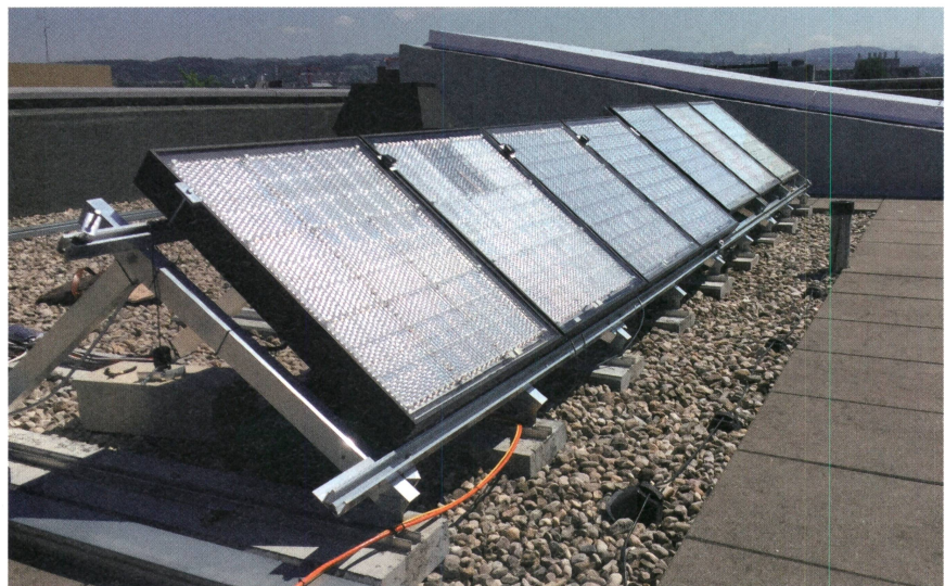
Figure 2 Installation pilote de modules Insolight à l'EPFL.
