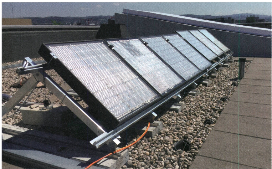
Figure 2 Installation pilote de modules Insolight à l'EPFL.
