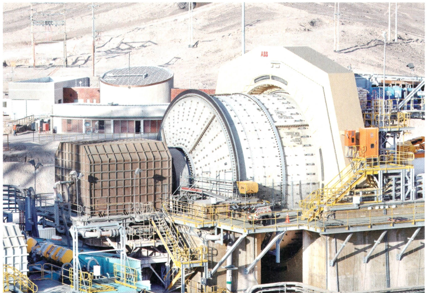
Un broyeur à minerai sans engrenage d'ABB: le CSEM utilise une telle installation dans le cadre d'un partenariat de recherche pour tester et développer sa solution de maintenance prédictive. Les algorithmes peuvent aussi être adaptés pour de petits systèmes.
