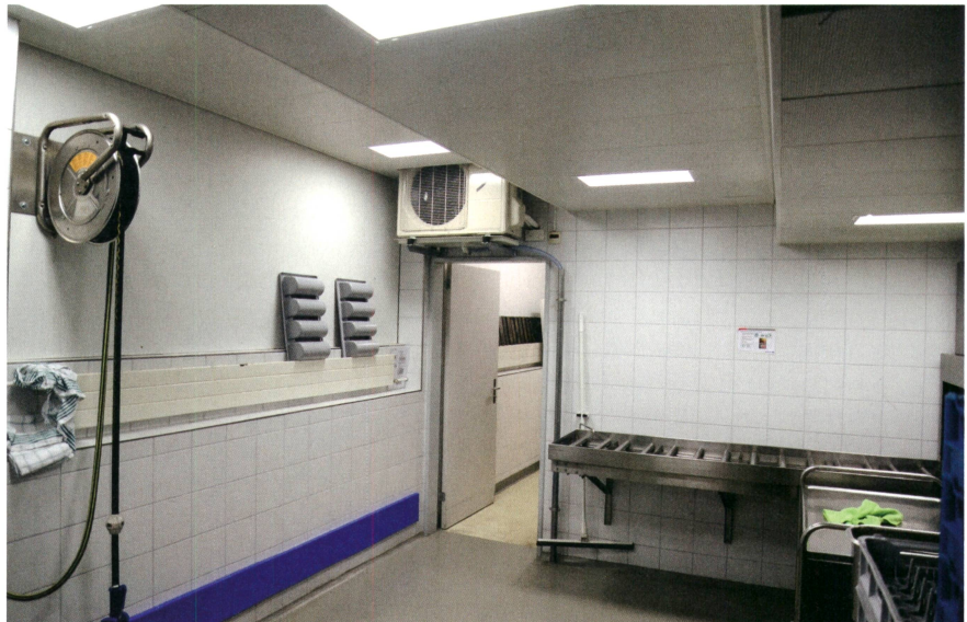
Auch im Abwaschraum profitiert man von der Wärmepumpe über der Türe.
