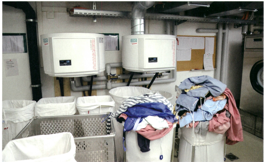
Die zwei Wärmepumpen in der Wäscherei verbessern das Arbeitsklima markant.
