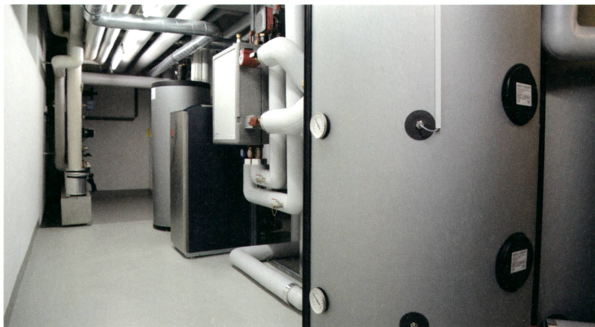
Das neue Energiekonzept sorgt nun dafür, dass es im Heizungsraum genügend Platz für Instandhaltungsarbeiten hat.
