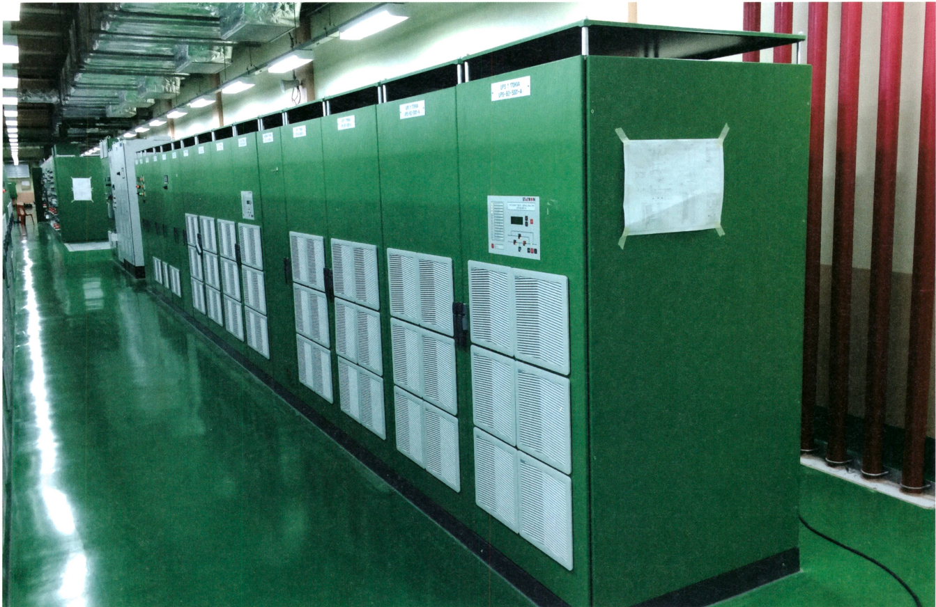
Installation einer modernen USV-Anlage mit PFC-Gleichrichter und Netzurückspeisung im Parallelbetrieb.
