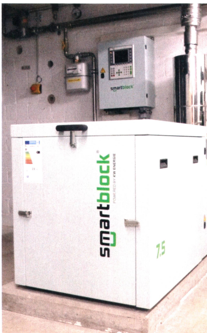
Bild 5 Smartblock-BHKW mit 7,5 kW elektrischer und 22,1 kW thermischer Leistung, im Heizraum inklusive Abgaskondensator.
