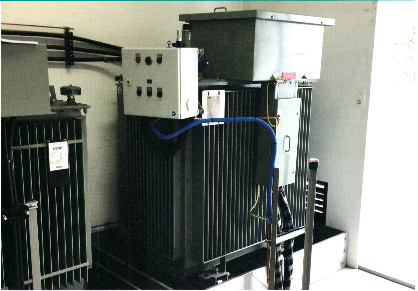
Im Vein-Projekt eingesetzte regelbare Trafos.
