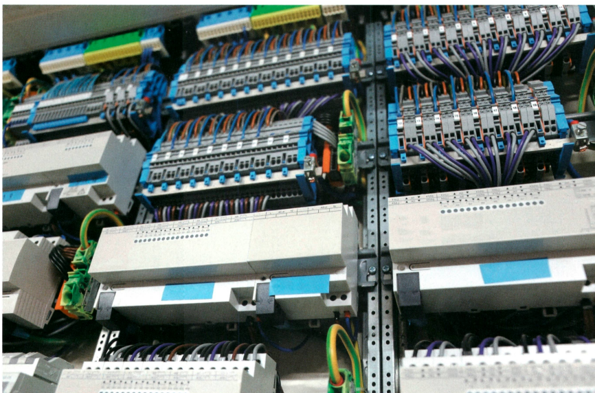
Les automatismes du bâtiment doivent partager leurs données avec l'informatique et nourrir des plateformes de services.
