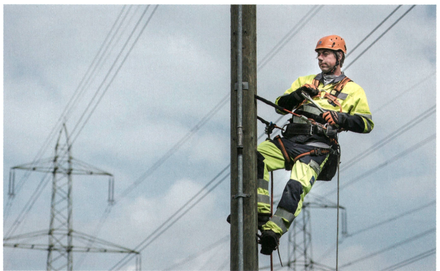
Arbeitssicherheit und Gesundheitsschutz sind bei der Arbeit mit Elektrizität von grösster Wichtigkeit.
