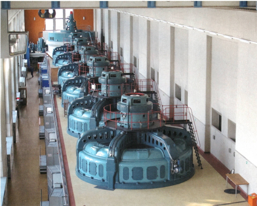
Bild 3: Wasserkraft (im Bild Turbinen im Wasserkraftwerk Mühleberg) ist investitionsintensiv.
