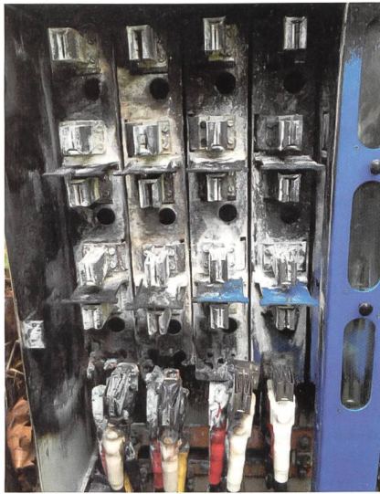
Bild 6 Durch Kurzschluss beschädigte Schaltgerätekombination ohne korrekte Schutzauslösung.
