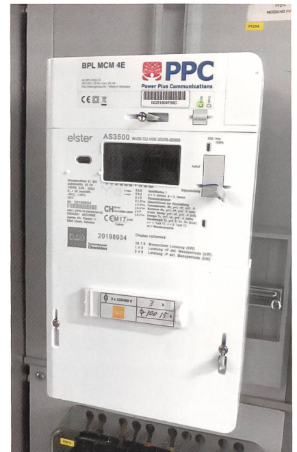
Ein Smart Meter mit BPL-Kommunikation.
