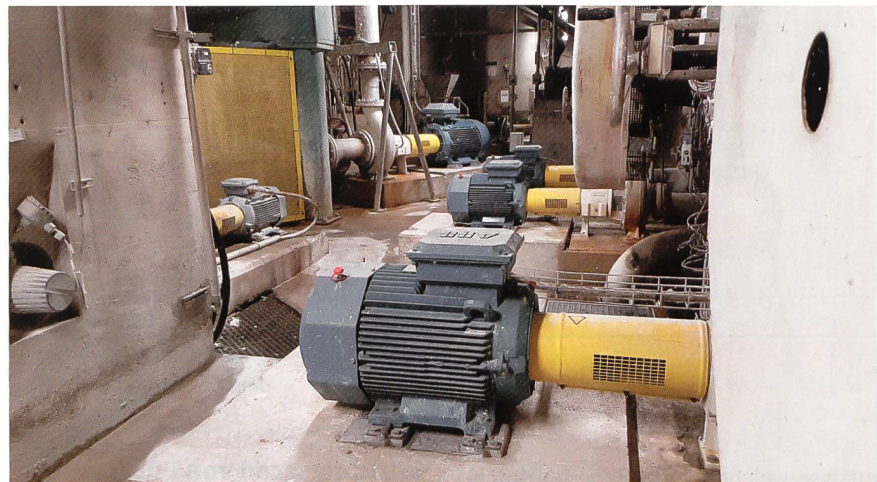
Kimberly-Clark senkte dank neuer Pumpen Kosten und Verbrauch um gut einen Drittel.
