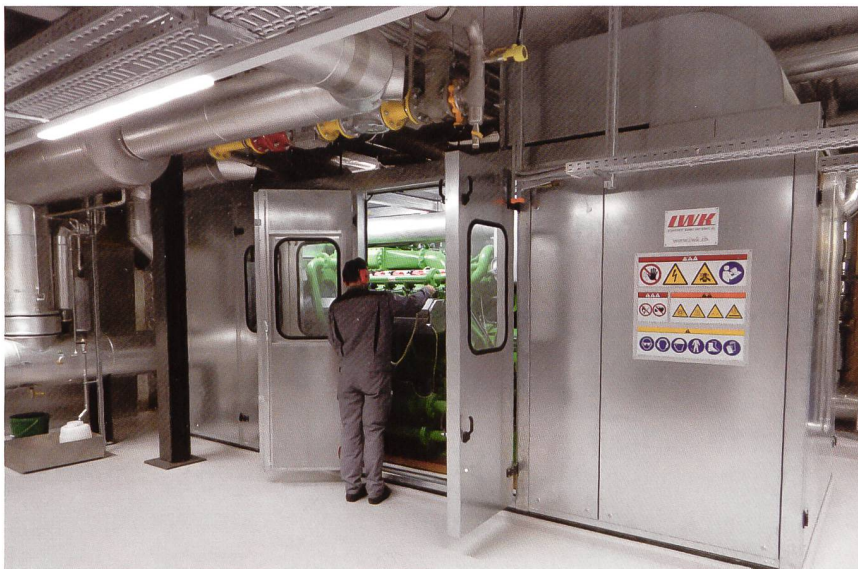
Figure 4 La centrale de cogénération de la station d'épuration Morgental de Steinaich (SG) produit de l'énergie électrique à partir des gaz d'épuration. La station d'épuration fait partie du pool d'énergie de réglage d'Alpiq.
