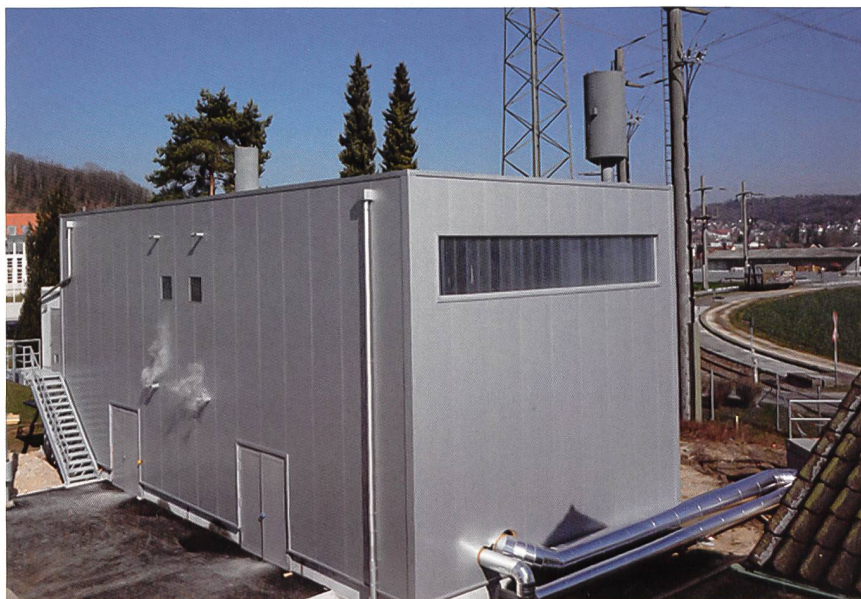
Die Power-to-Heat-Anlage in Niedergösgen hat eine Leistung von 22 MW.
