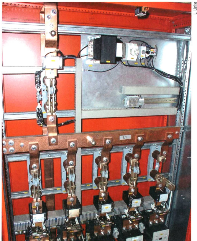
Bild 2 Sammelschiene 1 AC 1 kV 16,7 Hz DB-Zugheizstation.
