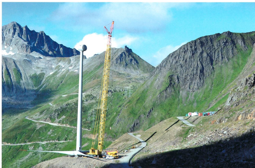
Bild 2 Vorbereitungen am Griespass für die Rotormontage auf einer der neuen Anlagen mit Nabenhöhe 131 m. Die engen Platzverhältnisse stellen dabei eine besondere Herausforderung dar. Im Hintergrund ist die Nufenenstrasse sichtbar.
