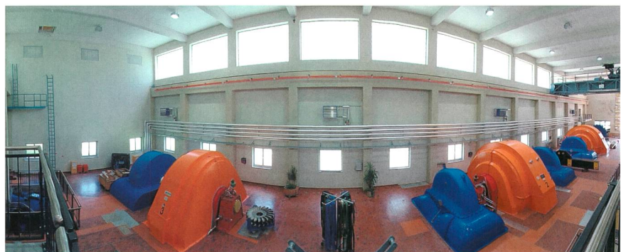
Ein Blick in das Maschinenhaus zeigt die drei revidierten Generatoren, die zuverlässig von einer neuen Löschanlage geschützt werden.
