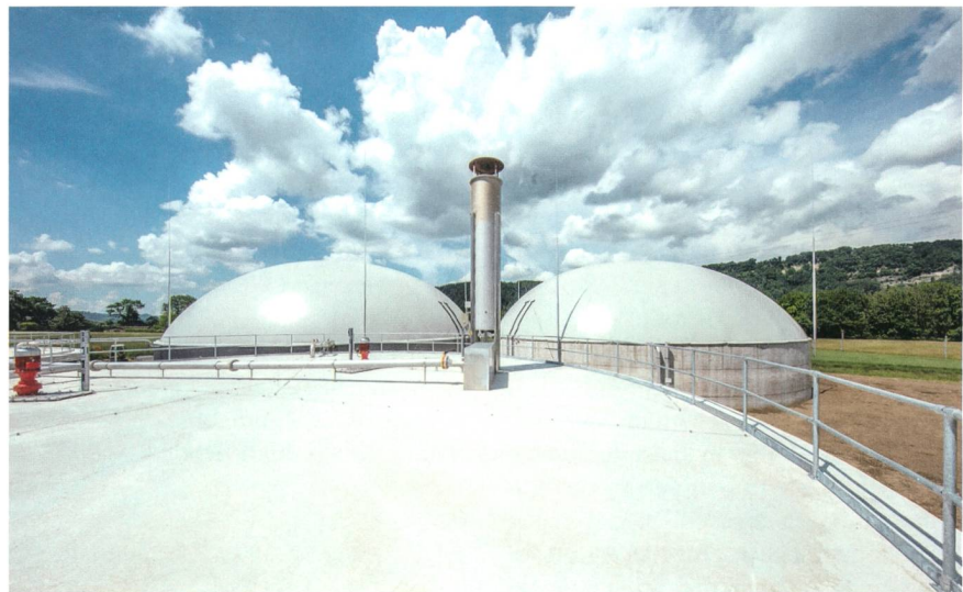
La nouvelle centrale est le fruit d'un partenariat pour une production locale et renouvelable.
