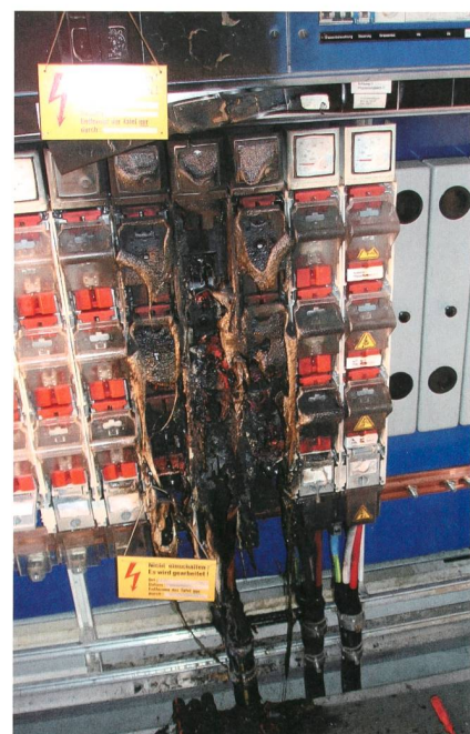
Danni dovuti a cortocircuito durante il lavoro; persona ferita gravemente.
