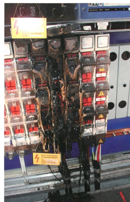
Dommages causés par un court-circuit lors de travaux; une personne grièvement blessée.
