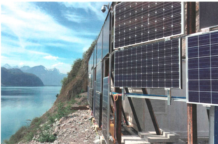
Seit Januar misst die temporäre Testanlage bis Frühjahr 2016 Stromerträge und Klimaverhältnisse.
