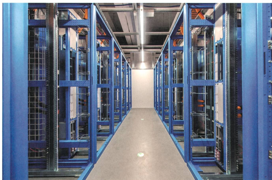
Das hochmoderne Swisscom-Rechenzentrum in Bern-Wankdorf gewann dieses Jahr einen Watt d'Or.
