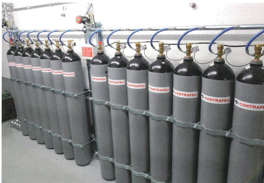
Stickstoffflaschenbatterie für zwei Löschbereiche mit mechanischer Blockiervorrichtung.
