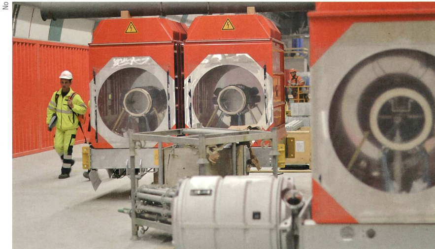
Bild 4 Generatorschalter im Montagebereich der Maschinenkaverne. Die Schalter werden bei ABB in Oerlikon hergestellt.
