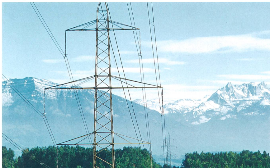
Der Umbau des Energiesystems kann nur gelingen, wenn der Ausbau von Produktion aus erneuerbaren Energien, Speicherung und Netzen aufeinander abgestimmt erfolgt. La mutation du système énergétique ne peut réussir que si la production à partir des énergies renouvelables, le stockage et les réseaux sont développés de manière concertée.
