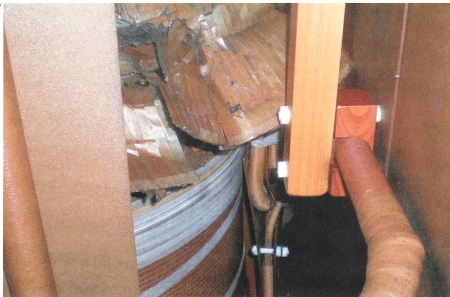
Bild 3 Transformator mit deutlichen Kupfersulfidablagerungen auf der Feststoffisolation.
