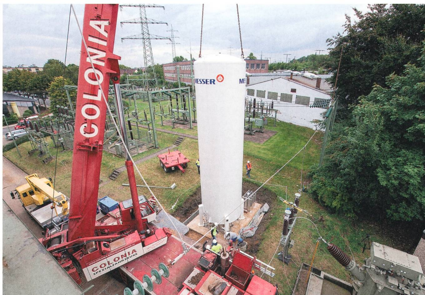
Bild 5 Aufstellung des Stickstofftanks in der Station Herkules.
